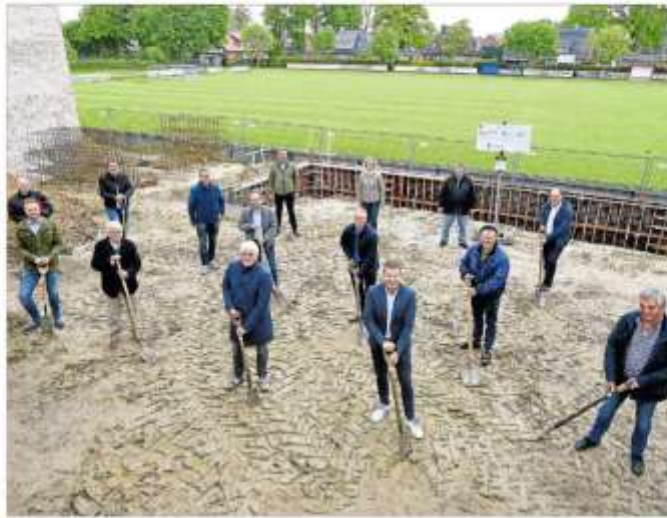
Vertreter des Vereins und der fördernden Institutionen beim symbolischen Spatenstich: Die Fertigstellung des Neubaus ist für Ende des Jahres vorgesehen. Das alte Clubhaus wird dann abgerissen und dort werden Parkplätze eingerichtet.
