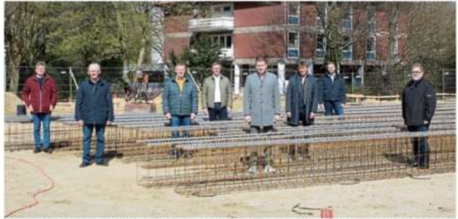
Die Bauarbeiten hinter dem Seniorenheim sind bereits in vollem Gange. Vertreter der katholischen Kirchengemeinde und der Verwaltung sowie Architekt Ewald Wehry (dritter von rechts) kamen am Mittwochmorgen zur Baustelle. BILD: MAREIKE WÜBBEN
